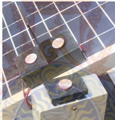
รูปที่ 3.10 ตำแหน่งการติดตั้งแอลดีอาร์ บนแผงเซลล์แสงอาทิตย์ (แอลดีอาร์ตัวที่ 1 ติดตั้งแบบคงที่ และแอลดีอาร์ตัวที่ 2 และตัวที่ 3 ติดตั้งบนแผงเซลล์แสงอาทิตย์ที่เคลื่อนที่)
