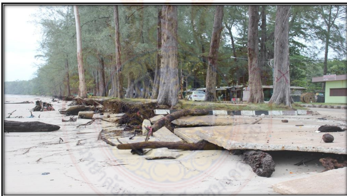
ภาพที่ 72 สถานที่หาดปากเมง อำเภอสิเกา จังหวัดตรัง ลักษณะของพื้นที่ที่เกิดการกัดเซาะบริเวณ ก่อนถึงแนวกันคลื่น
