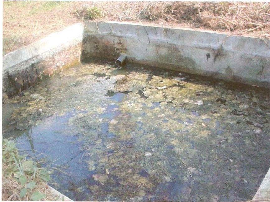
รูปผนวกที่ 1 บ่อดกตะกอนซึ่งมีท่อต่อน้ำทิ้งมาจากหอพักนักศึกษา
