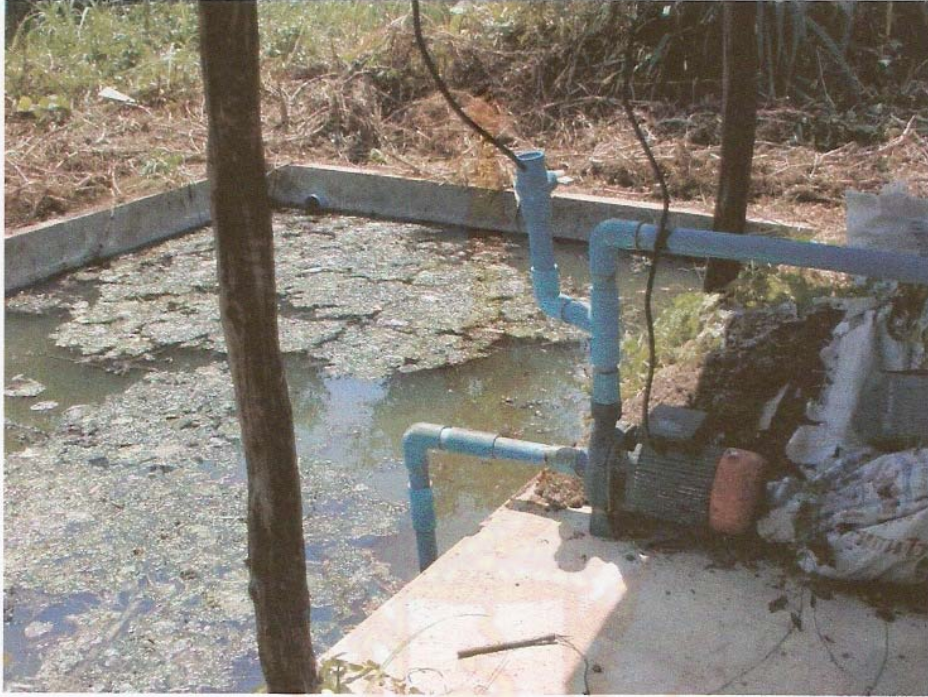
รูปผนวกที่ 9 ปิมน้ำที่ใช้สูบน้ำทิ้งในบ่อดกตะกอนส่งเข้าบ่อฝัง
