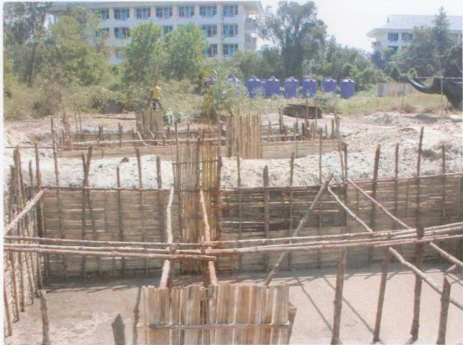
รูปผนวกที่ 7 บ่อบำบัดน้ำทิ้งแบบบ่อฝิ่ง บ่อฝิ่งที่ 2
