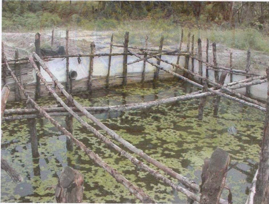
รูปผนวกที่ 10 ท่อน้ำล้นที่เชื่อมถึงกันระหว่างบ่อฝังที่ 1 บ่อฝังที่ 2 และบ่อปรับสภาพ
