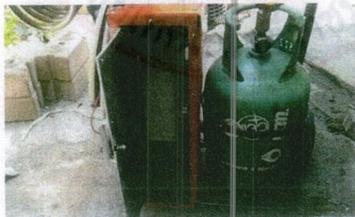
รูปที่ ข.15 ติดตั้งถังน้ำยาเคมี และแบตเตอรี่
