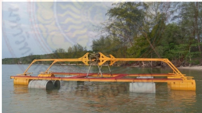
ภาพที่ 4-10 ติดตั้งระบบผลิตพลังงานไฟฟ้าด้วยคลื่นในทะเลในสถานที่จริง
