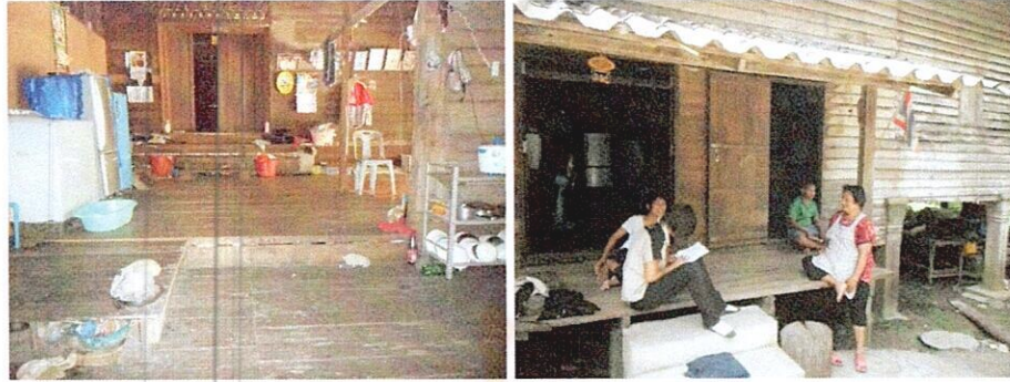
แสดงส่วนทางเชื่อมระหว่างครัวกับโถงกลางบ้าน
